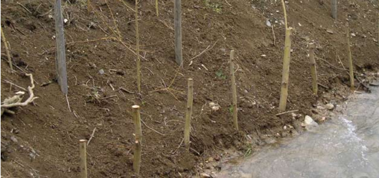
Abb. 4.27: Steckhölzer ragen viel zu weit aus dem Boden. Außerdem fehlende Ufersicherung an der Mittelwasserlinie, (Rems bei Mögglingen)
